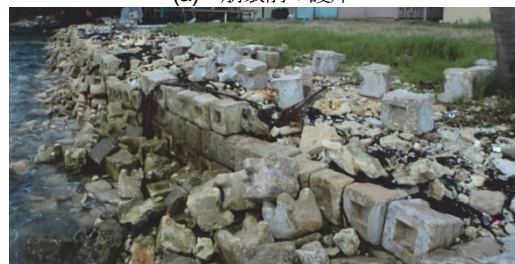
(b) 崩壊後の護岸
